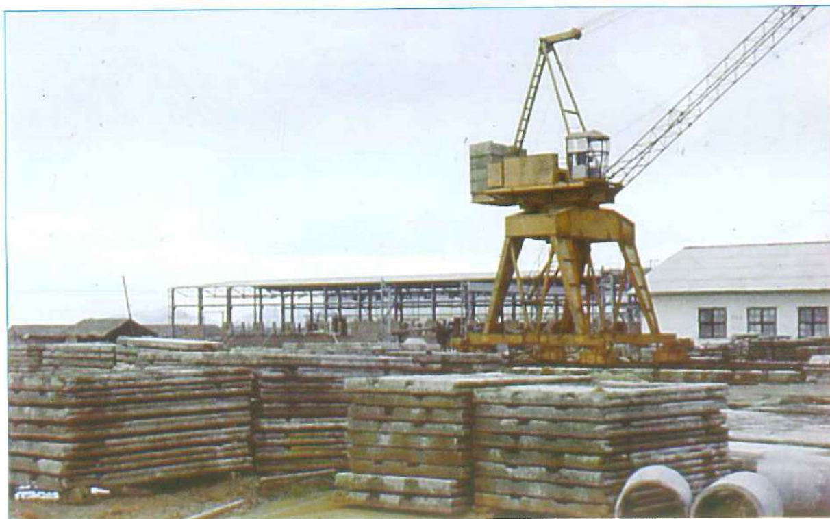
Cấu kiện bê tông đáp ứng yêu cầu xây dựng ở khu chung cư cao tầng Quang Trung
