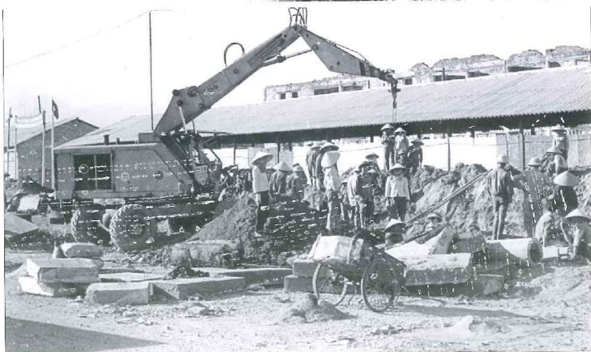
Hệ thống mương thoát nước mưa, nước bẩn từ khu Quang Trung ra khu xử lý Vinh Tân đang xây dựng
