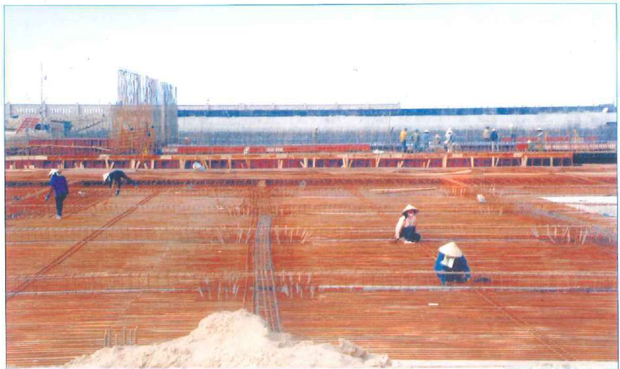
Khu xử lý nước thải thành phố 31.000m 3 /ngày, đê đang xây dựng tại xã Hưng Hòa nguồn viện trợ ODA (ảnh chụp 7/2010)
